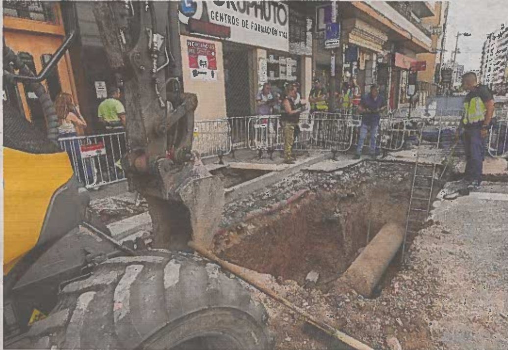
Un trabajador perdió la vida en agosto en esta zanja de la avenida de Goya de Zaragoza. OLIVER DUCH
